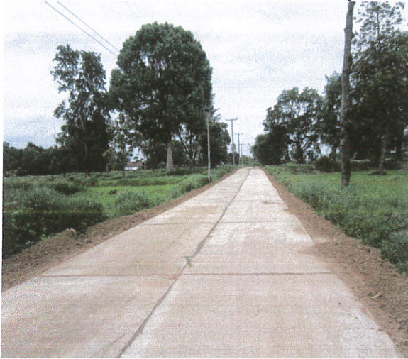
ก่อสร้างถนนคอนกรีตเสริมเหล็ก เชื่อมต่อบ้านนากระแซง หมู่2 (ซอยข้างวัดนากระแซง) ถึงบ้านไทยวัฒนา หมู่ 3
